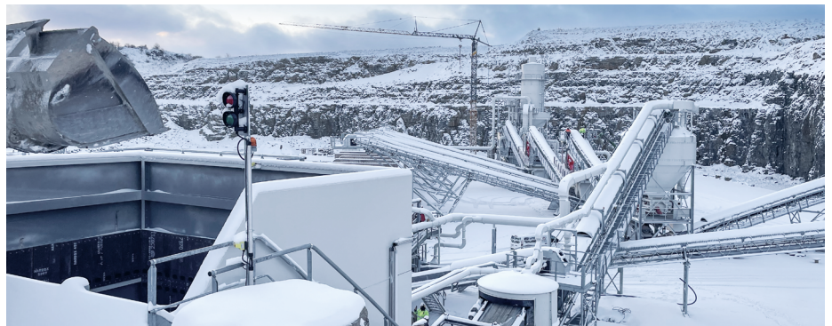
Die neue stationäre Aufbereitungsanlage ersetzt die dieselbetriebenen mobilen Brecher und Siebmaschinen. Ihr Energiebedarf wird zunächst durch grünen Strom aus Wasserkraft gedeckt und mittelfristig durch selbst erzeugten Solarstrom aus der geplanten Photovoltaik-Anlage. © Mineral Baustoff GmbH
